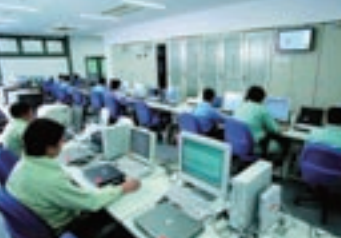
制御監視システム
