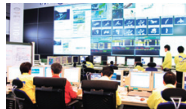
NTT東日本ネットワークオペレーションセンタ内部
