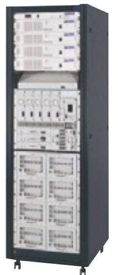
バックアップ電源装置
