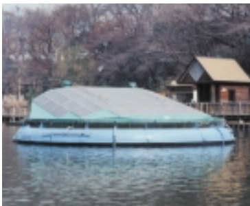
写真4.2-2 水浄化用太陽光発電システム
