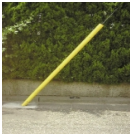
写真3.4-1 電柱支線ガード
