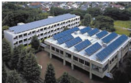
写真2 太陽光発電システム
