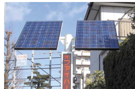
太陽光発電システム
