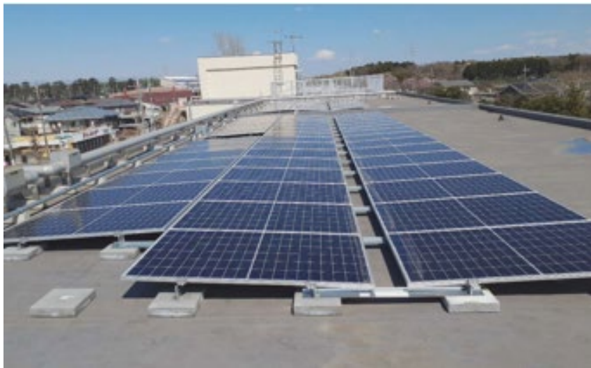
市内の避難所（公民館・市立学校）に 太陽光発電設備と蓄電池を設置
