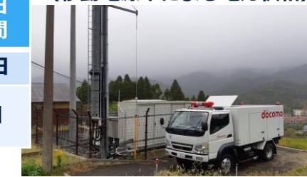
（移動電源車による電力供給）
