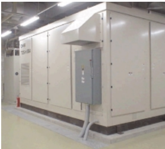
写真4.2-4 マルチ燃料型燃料電池
