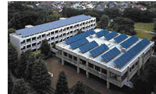
写真2 太陽光発電システム
